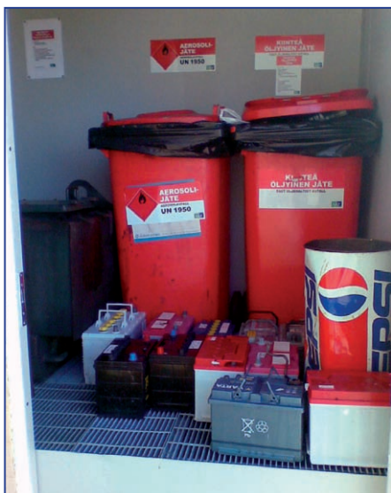
Ongelmajätteet säilytetään lukitussa ja suoja-altaalla varustetussa tilassa.
