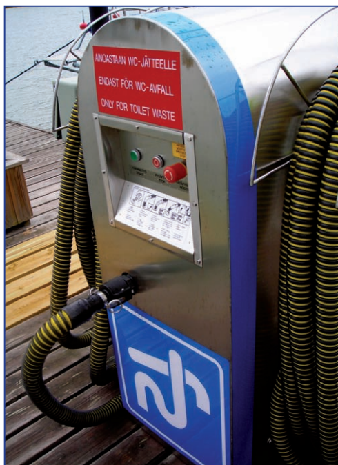
Laiturille asennettu imutyhjennyslaitteisto.
